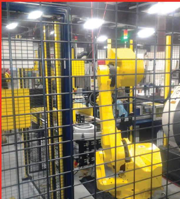
Cellule robotisée CNC Solutions, créée avec la technologie SOLIDWORKS Electrical
